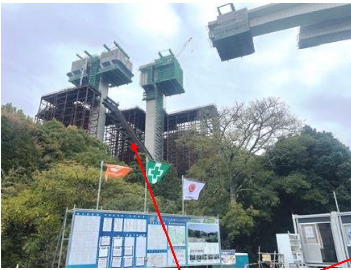
資材運搬用のインクライン (最大積載量 65 t = ミキサー車 3 台同時可)
